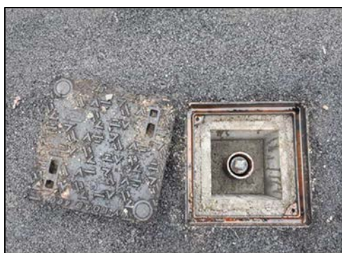
Réhausse du carré de manœuvre avec tampon en fonte (vanne de remplissage)
